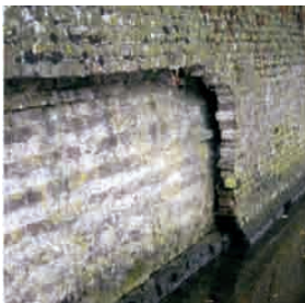
Afgescheurde schil metselwerk
