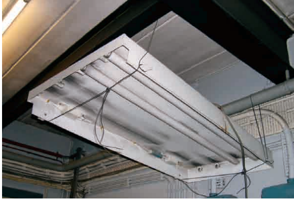
Provisorisch opgehangen armatuur in conditie 4
