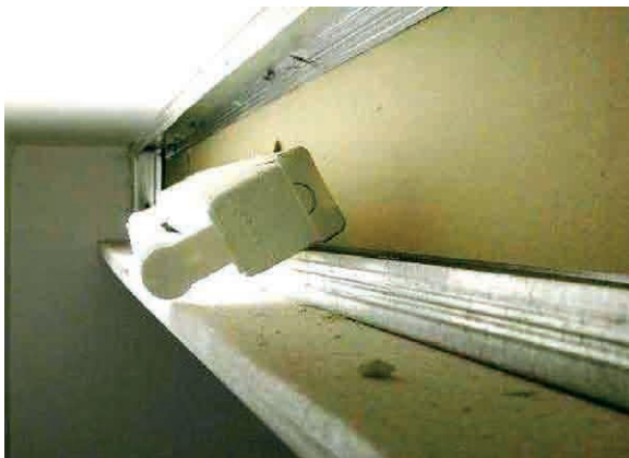
Loshangende TI-armatuur in conditie 2
