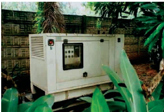
Noodstroomaggregaat in fluisterstille behuizing
