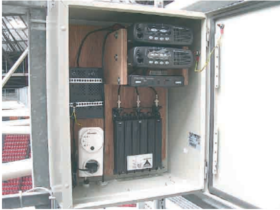
Mobilfoon installatie in conditie 1
