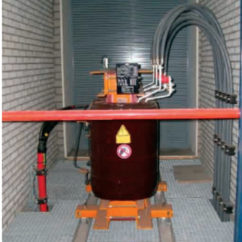
Transformator in nieuwstaat
