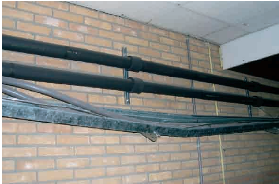
Op een enkele plaats doorgebogen goot, conditie 2
