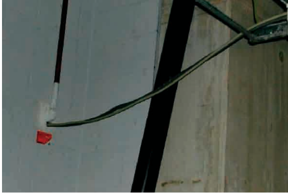
Ondersteunende kabelgoot ontbreekt
