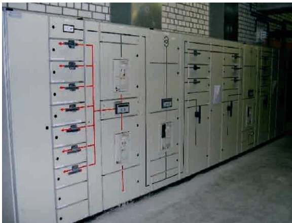
Plaatstalen hoofdverdeelinrichting in nieuwstaat
