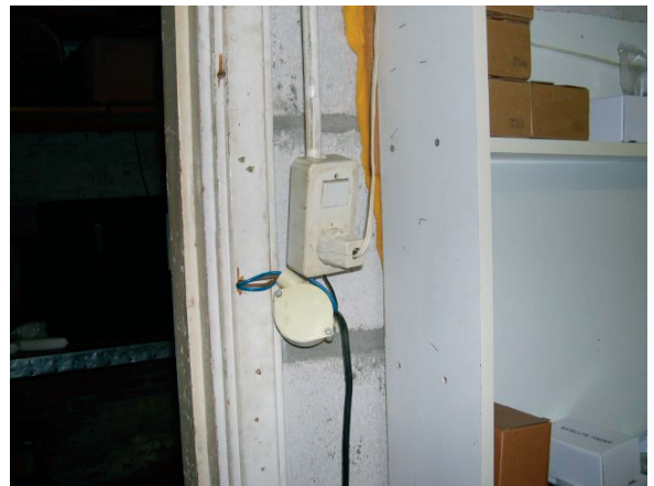
Laagspanningsinstallatie in conditie 4
