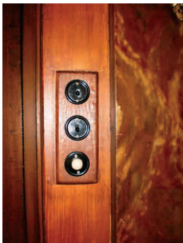
Schakelmateriaal van historische waarde
